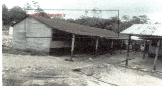
Foto 1 es necesario Cambiar el techo porque se encuentra destruido.
