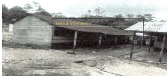
foto 3. Cambiar lamina al corredor porque esta todo roto.
